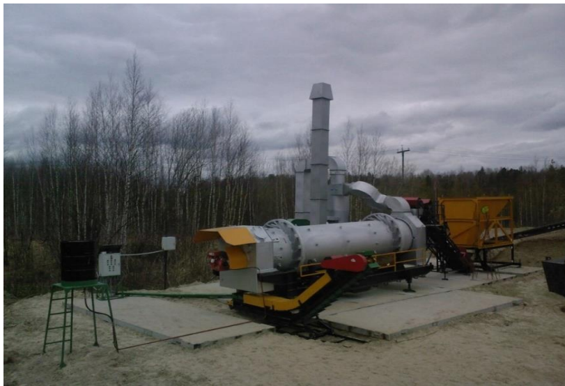
Рис. 2. Установка утилизации загрязненных грунтов (фото из архива ОАО «Грознефтегаз»)
